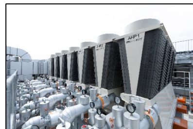
空気熱源ヒートポンプ
