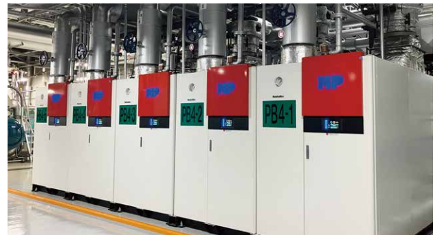
丸の内一丁目センターに設置された貫流ボイラ
