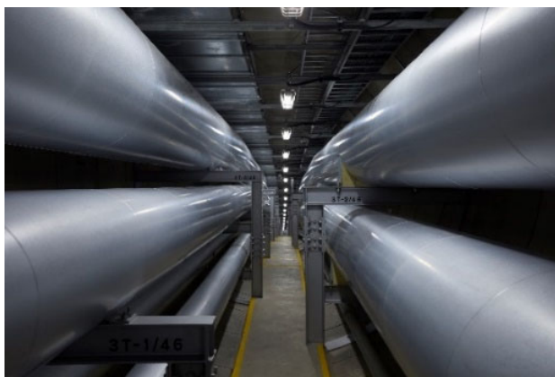
熱を供給する地下配管
