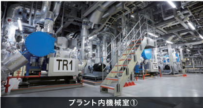
プラント内機械室①
