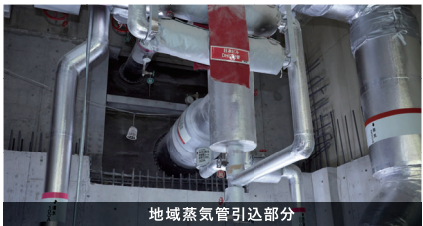
地域蒸気管引込部分
