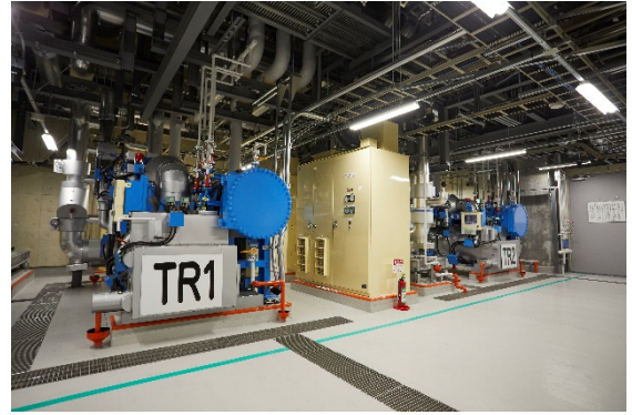
日比谷 FORT TOWER サプラント 冷凍機室 (地上3階)
