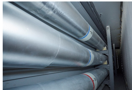
地域配管(地下連絡通路内)
