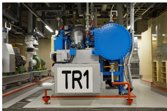
写真-1 日比谷 FORT TOWER サブプラント インバータターボ冷凍機
