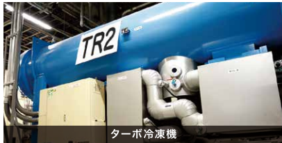
ターボ冷凍機
