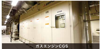
ガスエンジンCGS
