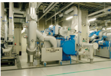
ターボ冷凍機（1300RT）
