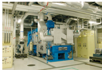
吸収式冷凍機（1200RT）
