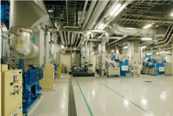
冷凍機専用サブプラント
