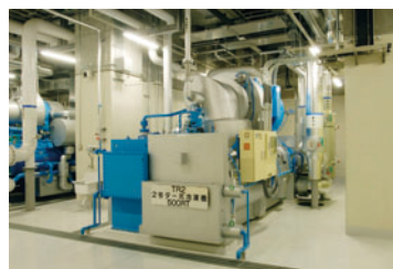
ターボ冷凍機（500RT）
